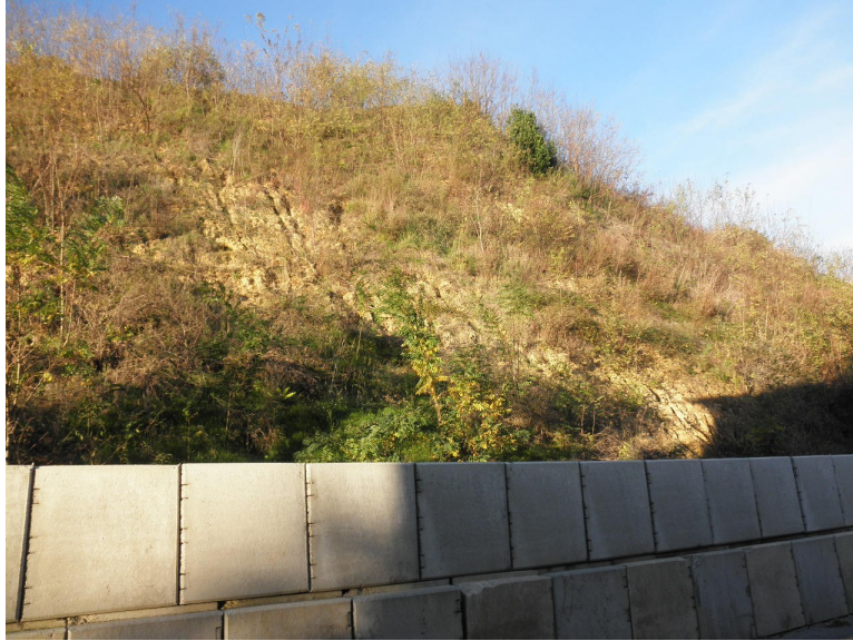
Foto n. 3 – Vegetazione infestante e canali che si sono formati lungo il versante a causa dell'acqua di ruscellamento
