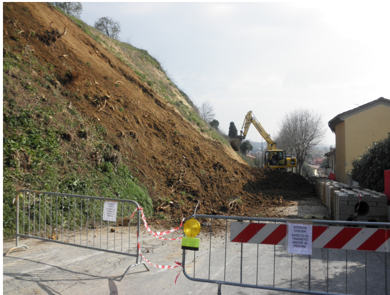
Foto n. 2: movimento franoso dell'anno 2014
